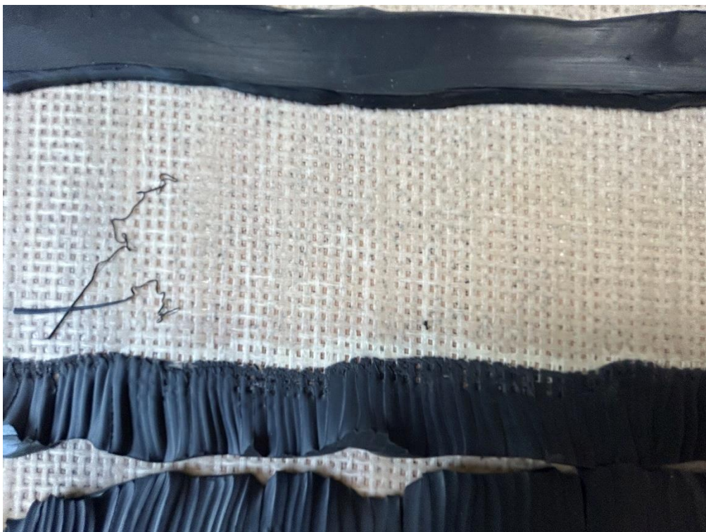
Płyta A widoczne odspojenie
